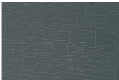
Forbindelsen er ødelagt på grund af UV strålingen
